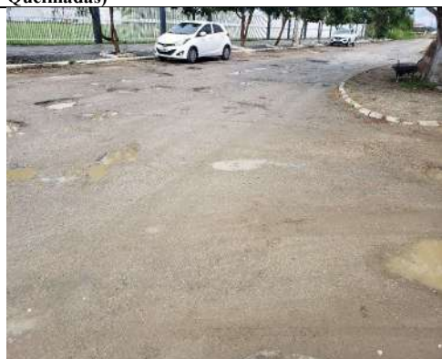
Foto 4 – Acúmulos de água na pavimentação (Acesso DI Queimadas)
