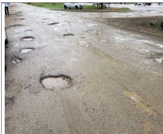
Foto 1 – Vista da via danificada (Acesso DI Queimadas)
