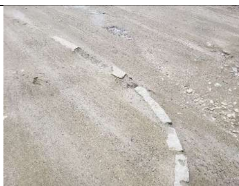
Foto 6 – Meio fio afundado e danificado (Acesso DI Queimadas)
