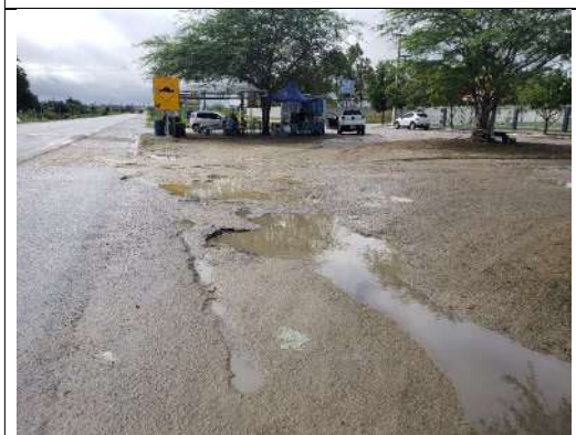
Foto 3 – Canteiros e acessos danificados (Acesso DI Queimadas)
